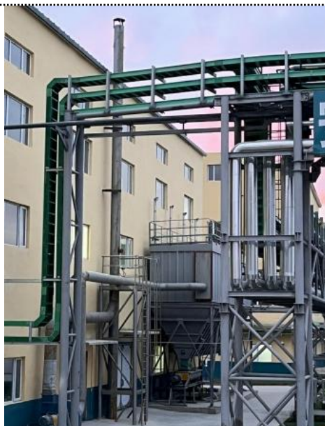
焙烧车间破碎筛分除尘器、排气筒
