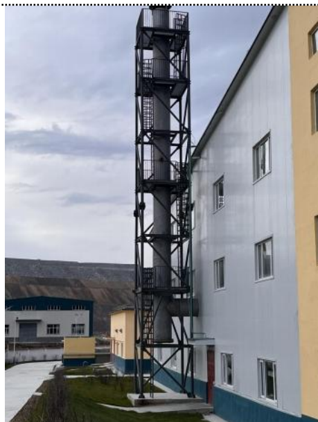
焙烧车间燃烧废气排气筒
