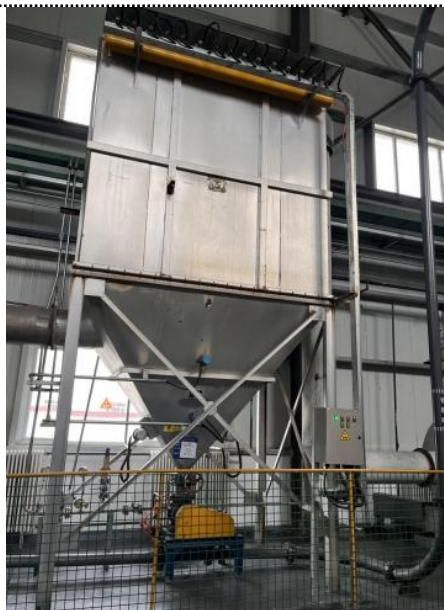
原料车间除尘器
