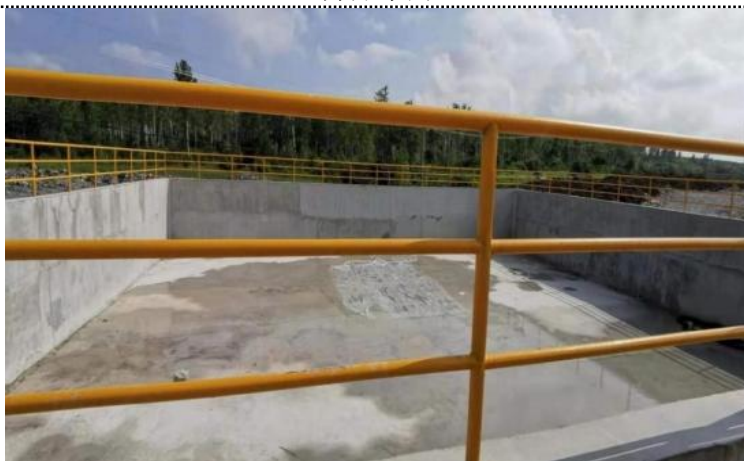
排土场沉淀池
