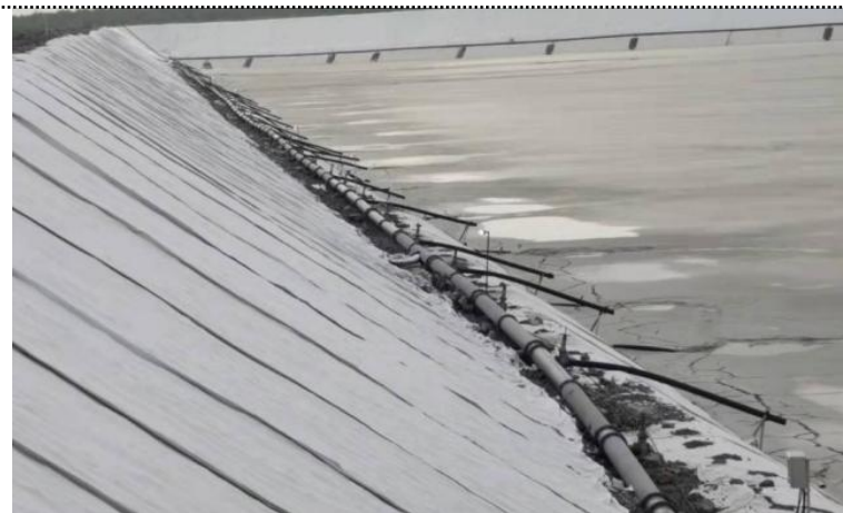
尾矿输送管线
