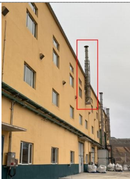
废水处理车间排气筒
